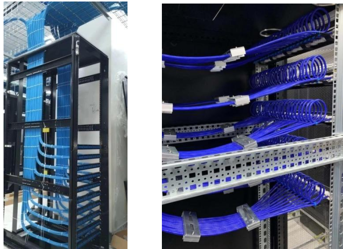
图 3 综合布线系统机柜内理线工艺
